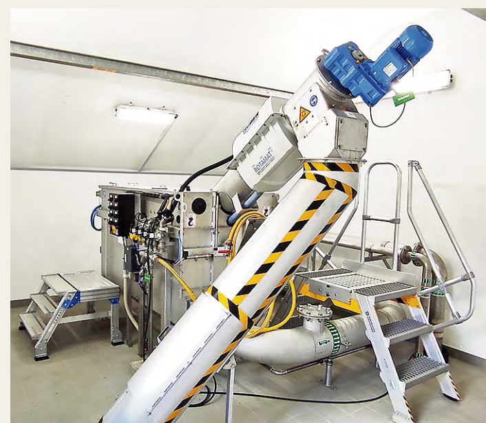
Die neue Siebrechenanlage entfernt alle Grobstoffe ab drei Millimeter Größe.
