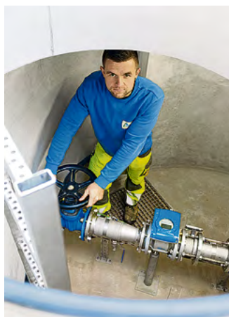
↑ Rein in die gute (Brunnen-)Stube: Michel Königer kontrolliert, ob der Rohwasserzufluss ins Wasserwerk auch ordnungsgemäß funktioniert.
