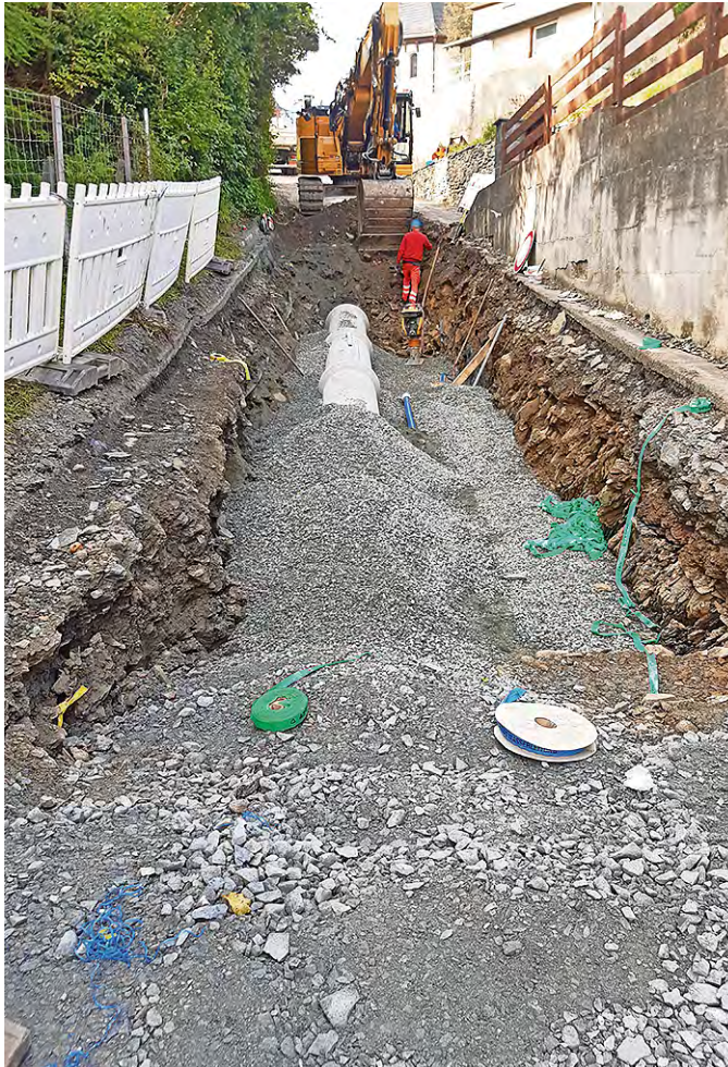
Durch die neue Trinkwasserleitung wird die Wasserversorgung des Schleizer Ortsteils Grochwitz sichergestellt. Foto: Brunzel
