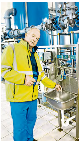
↑ Bei der Trinkwasseraufbereitung werden je nach Rohwasser-Qualität unterschiedliche Stoffe eliminiert. Ralf Schüler misst hier nach, wie hoch der Chloranteil im Wasser ist.
