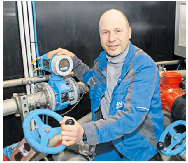
Tim Winkler dreht am Rad – natürlich nur zur Steuerung der Pumpen in der 2-Phasen-Faulungsanlage. Fotos (2): SPREE-PR/Wolf
