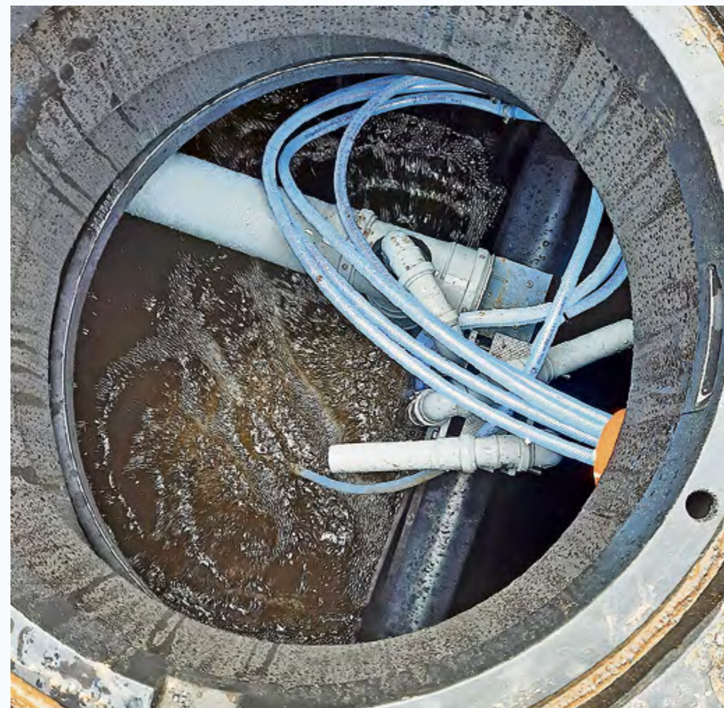
Blick in eine Kleinkläranlage während der Belüftungsphase.
