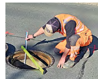
Marcel Jaisczok bei der Dokumentation von defekten Schachtabdeckungen, die anschließend mit einer Vertragsfirma saniert werden. Foto: Jaisczok/ZWOS
